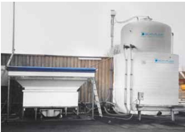
Komplet anlæg med blandeanlæg, lagertank med miljøsikkerhedskar samt pumpearrangement for påfyldning
